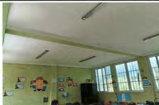
Foto 10: Sustituir lamparas de bicarbonato, por plafoneras en virtud que estan dañadas
