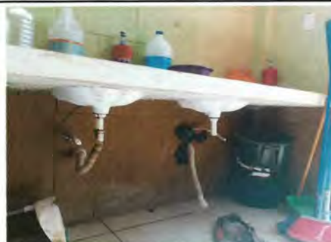
Foto 4: MODULO 2: Sustituir sanitarios y lavamanos que se encuentran en mal estado
